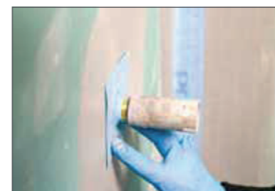
Abb. 3: Korrekt anliegende Dichtmanschette an einer Rohrdurchführung
